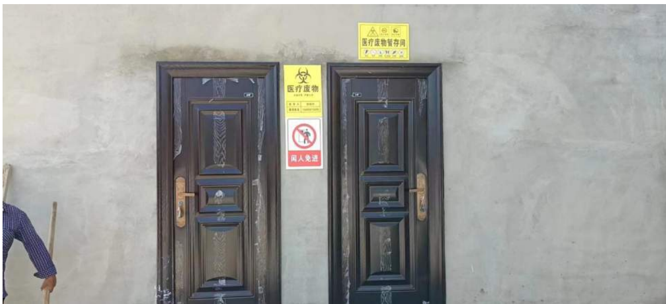
附图 3、危废暂存间
