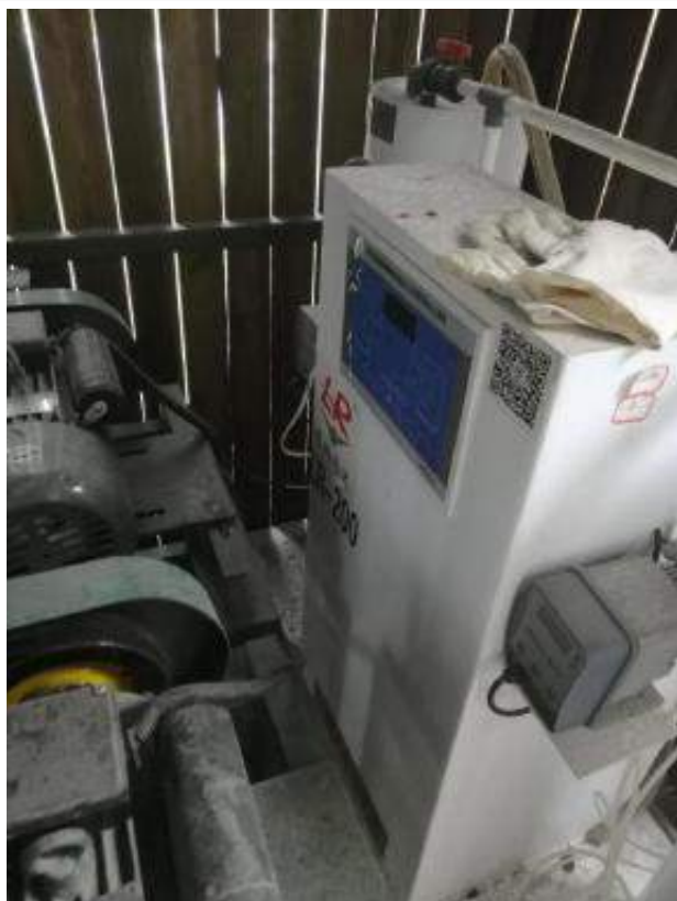
污水处理设备
